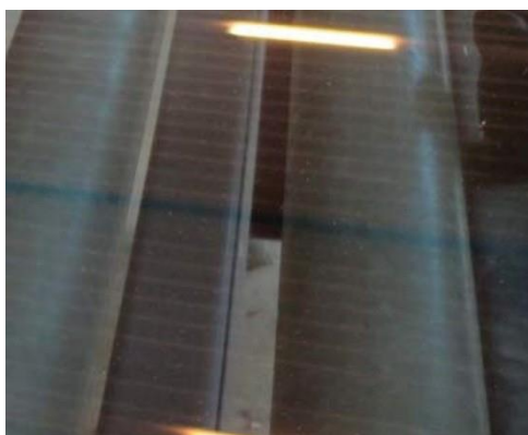
Detección de recubrimiento Capa sin EASYPRO®
